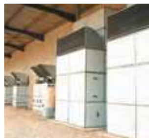
Ventilation répondant aux normes sanitaires et environnementales
