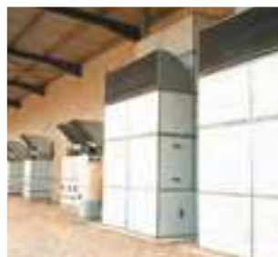
Ventilation répondant aux normes sanitaires et environnementales
