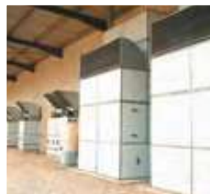
Ventilation répondant aux normes sanitaires et environnementales
