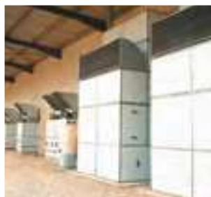
Ventilation répondant aux normes sanitaires et environnementales
